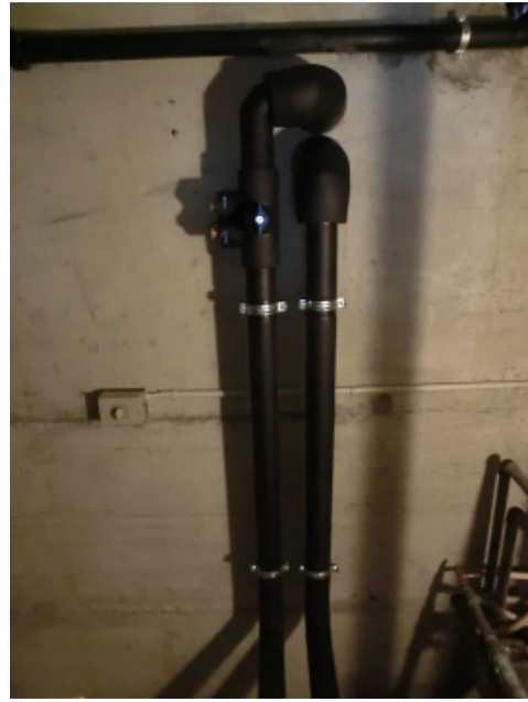
Eintritt der Erdsonde in Heizraum.
